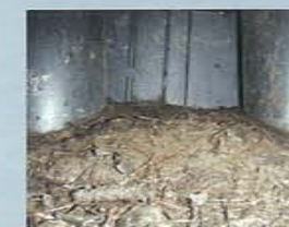
堆砂抑制システム内部 約10cmの土砂堆積
